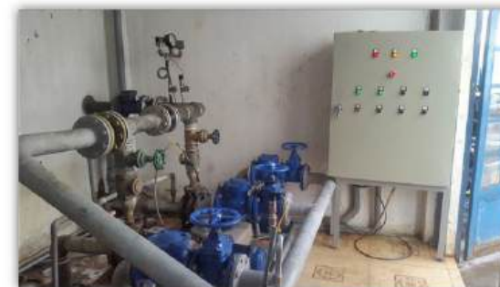
Thiết kế và thi công tủ điều khiển bơm quay của nhà máy
