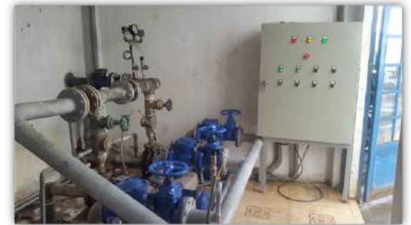
공장의 로터리 펌프 제어 캐비닛 설계 및 시공
